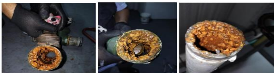
*Ejemplo de corrosión interna en tubería de material Galvanizado.
